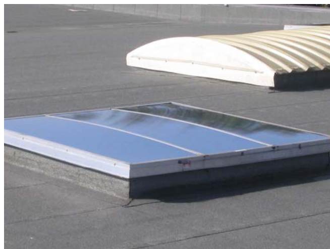
Baumann Ressorts : 10 exutoires de fumées : 30 m2
